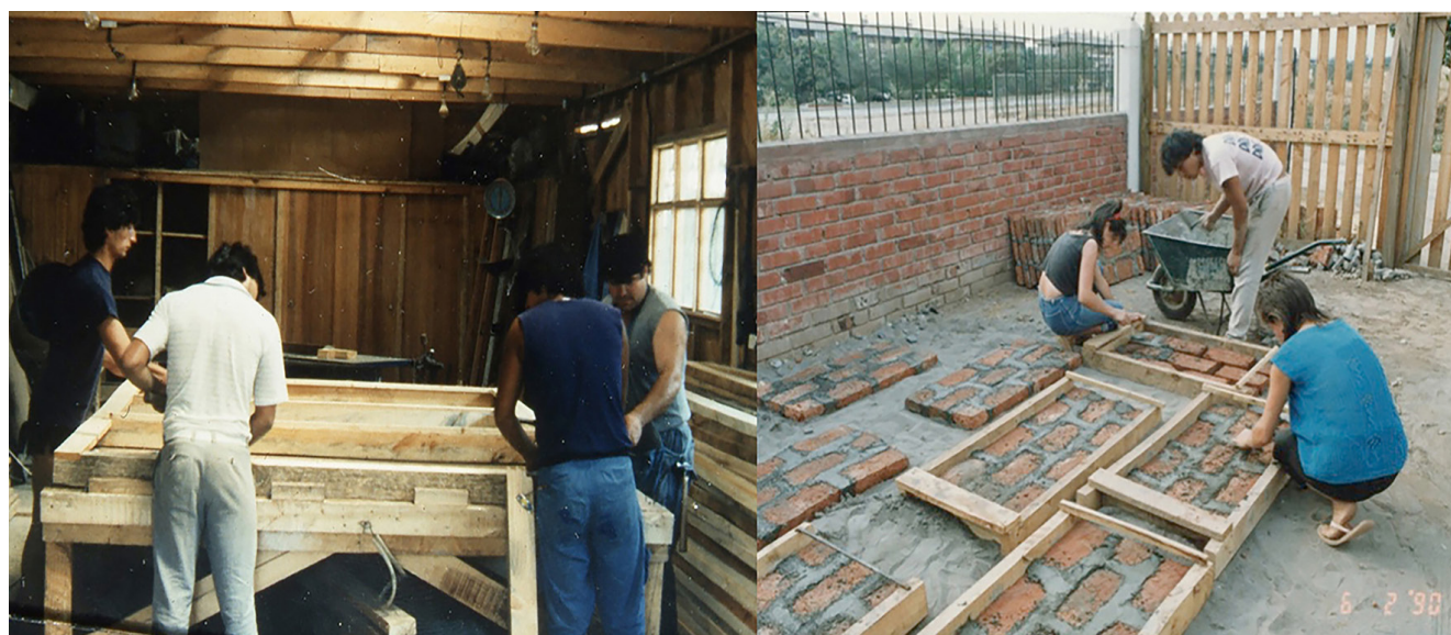
Figura 5. Prefabricación de paneles de muro en madera en taller y prefabricación de losetas de ladrillo en del patio taller.
