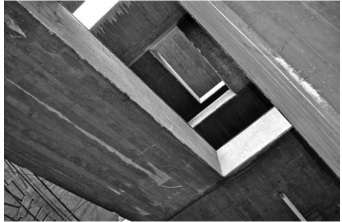
Imagen 8. Trama de vigas y losas, Unidad Vecinal Portales (fuente: Archivo Revista Arteoficio, Escuela de Arquitectura, Universidad de Santiago de Chile).
